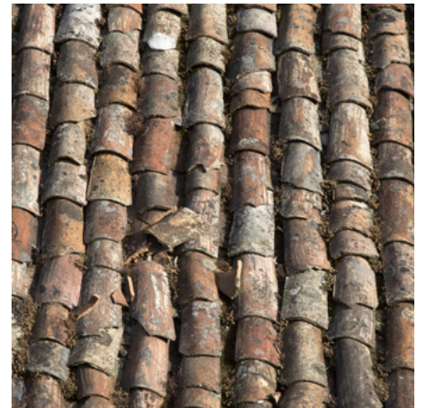
Deterioramento del manto di copertura
